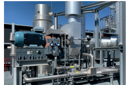
Ventilador de alto rendimiento de PILLER en la planta de bioetanol
